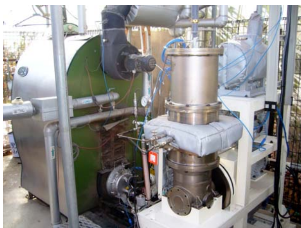
図 11 木質バイオマスボイラーと LISE
