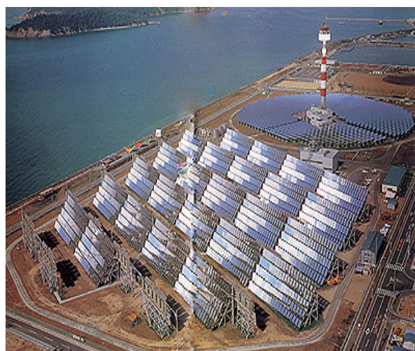
写真1 仁尾町太陽熱実証実験設備
