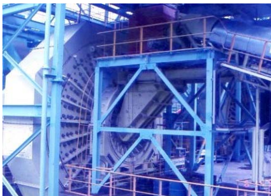
図12：RCD工法における自生粉砕製砂設備
